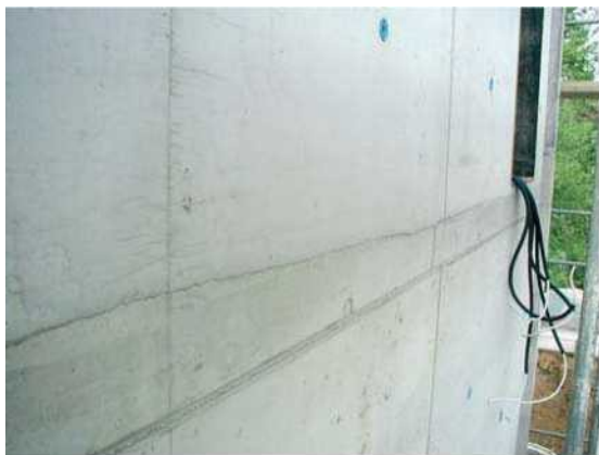
Obrázek 7 – Pohledový konstrukční spoj (Nepřijatelný)
