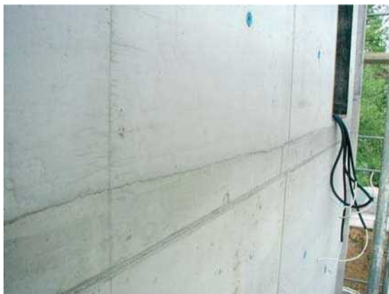
Slika 7. – Vidljiv spoj konstrukcije (nije prihvatljivo)
