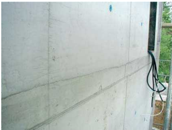
Εικόνα 7 - Εμφανής αρμός εργασίας (μη αποδεκτός)
