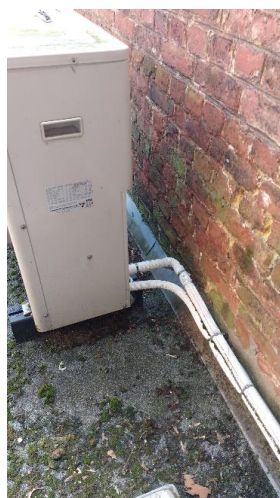
Figuur 58: Voorbeeld van een geïsoleerde koelmiddelleiding verbonden aan een buiteneenheid
