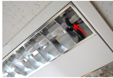
Figuur 92: Daglichtsensor op TL-verlichting in een armatuur
