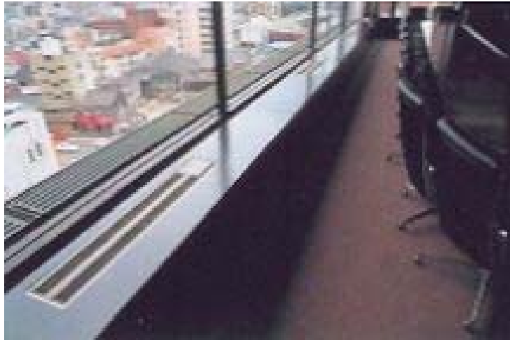
Figuur 202: Ventilconvector ingewerkt onder de ramen
