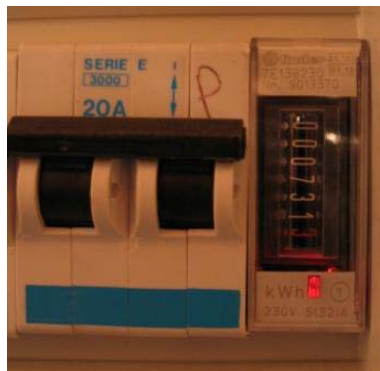
Figuur 140: Extra elektriciteitsteller
