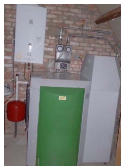
Pelletketel met zuigsysteem en opslag
