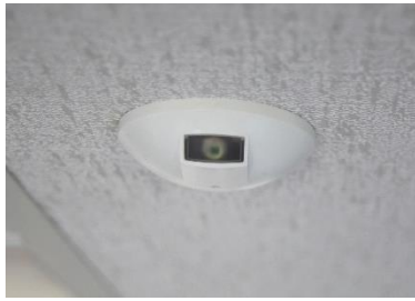
Figuur 91: Daglichtsensor aan het plafond
