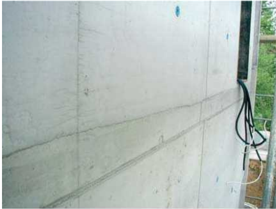
Figur 7 — Synlige konstruktionssamlinger (ikke acceptabelt)
