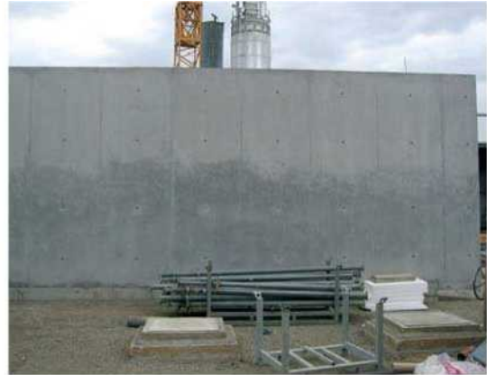
Figur 8 - Synlig farveforskel (ikke acceptabelt)
