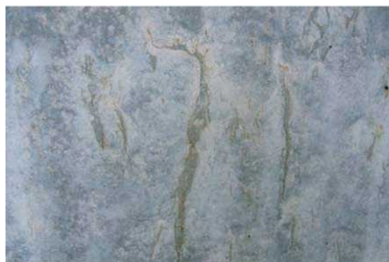
Rys. 4 – Przebarwienia spowodowane przedawkowaniem środka antyadhezyjnego
