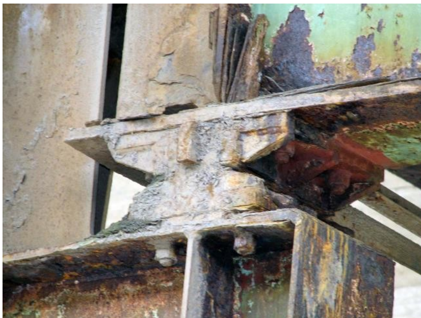
Slika 245: Linijsko nagibno ležišče – močna korozija in siganje.
