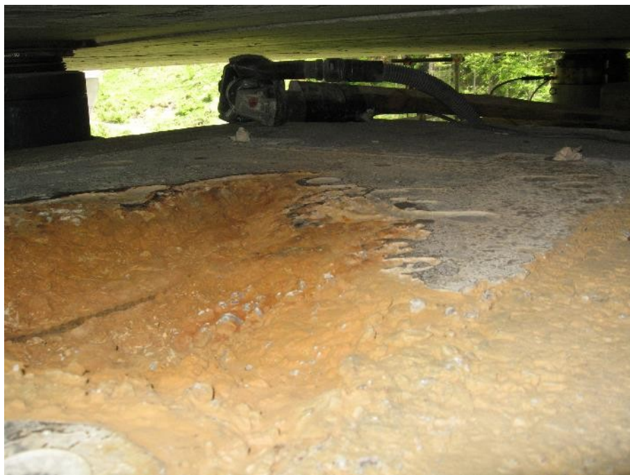
Slika 234: Depresija v betonskem podstavku zaradi napake pri podlivanju lončnega ležišča.
