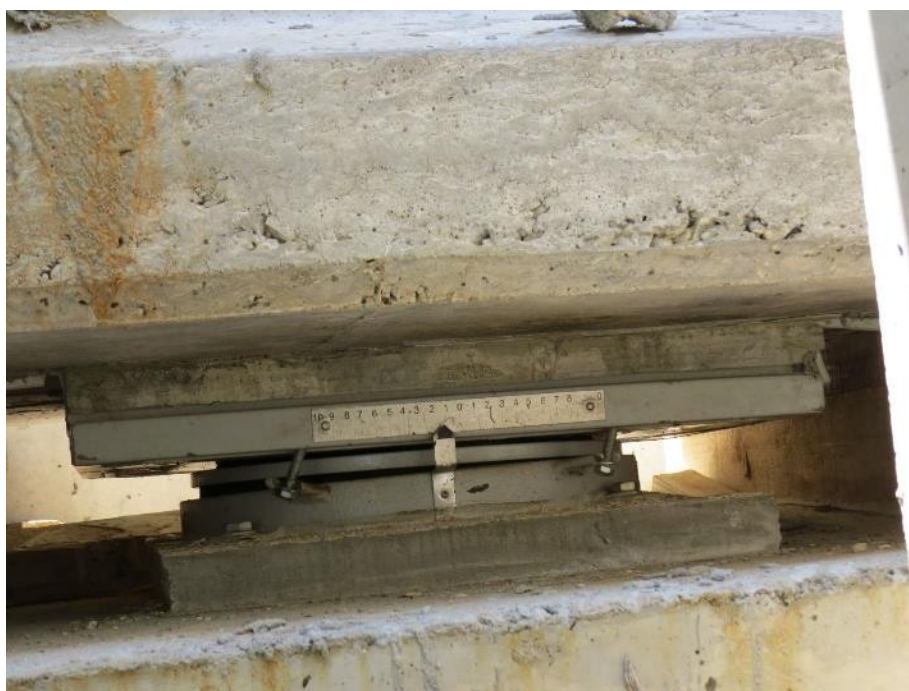
Slika 229: Prevelik zasuk lončnega ležišča pod montažnim betonskim nosilcem.
