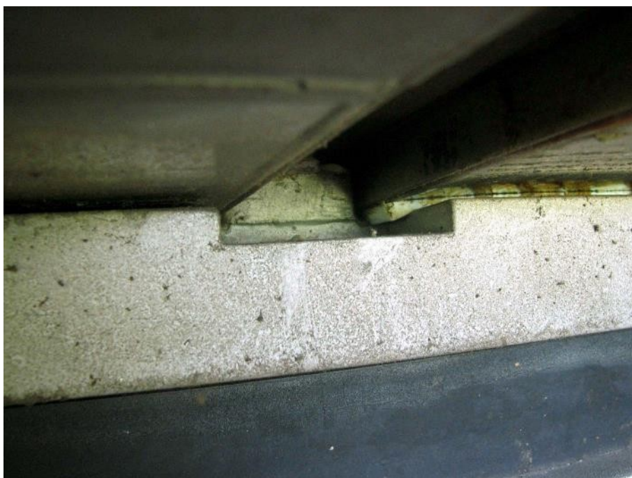
Slika 177: Iztiskanje teflona iz utora zgornje nosilne plošče deformabilnega drsnega ležišča.
