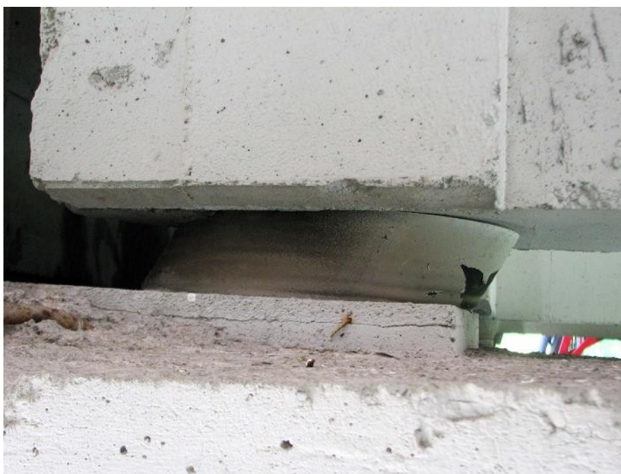
Slika 116: Ležišče vgrajeno preblizu roba ležiščne blazine. Na čelni kontaktne površini špranja med ležiščem in prekladno konstrukcijo. Ležišče ni vgrajeno horizontalno.
