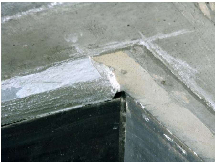
Slika 146: Odlom zgornjega venca zaradi zdrsavanja ležišča. Nepravilna izvedba.
