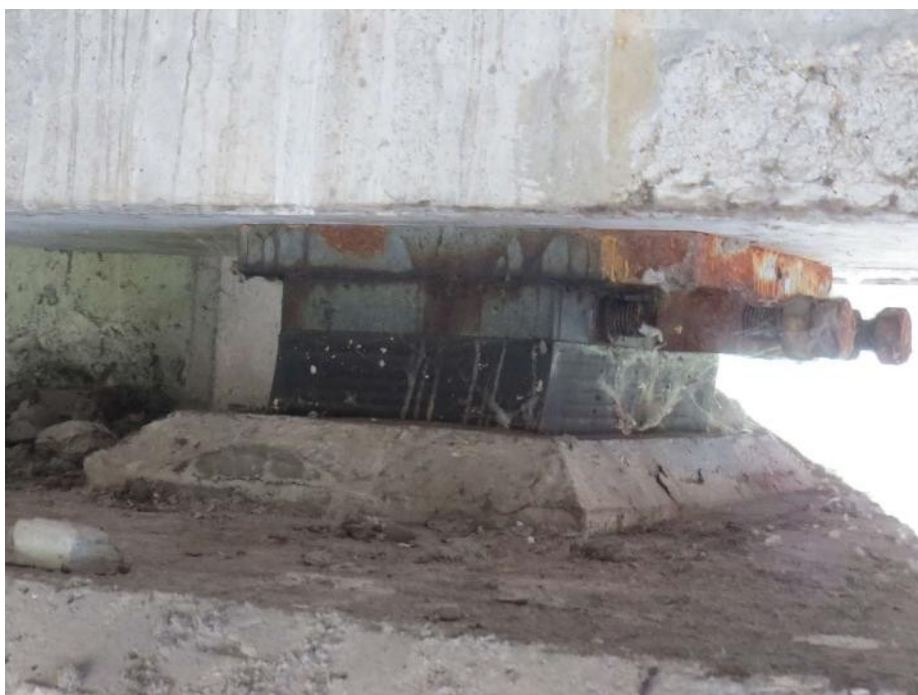
Slika 173: Korozija jeklene konstrukcije elastomernega ležišča z mehanizmom za ponastavitev ležišča.
