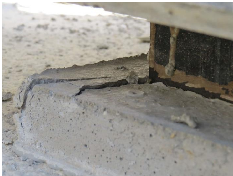
Slika 161: Neustrezna in nepravilna vgradnja elastomernega ležišča pod betonskim montažnim nosilcem. Ležišče zalito v podlivno malto.
