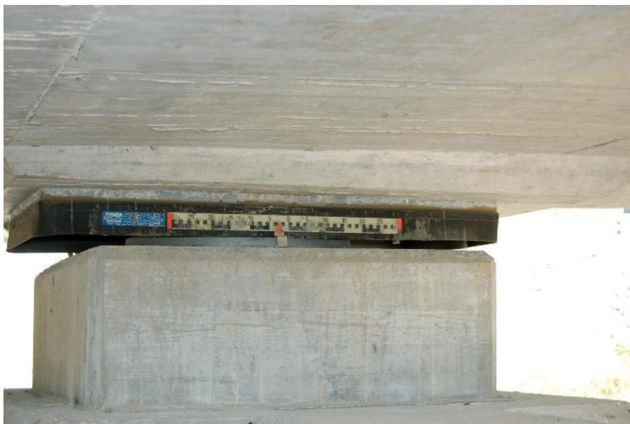
Slika 264: Velikost ležiščnega podstavka neustrezna z ozirom na velikost drsne plošče in premajhnega odmika drsne površine drsne plošče od zgornje površine ležiščnega podstavka.
