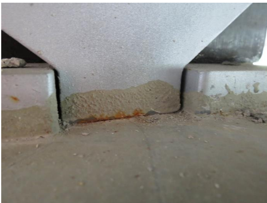
Slika 109: Nepravilna izvedba in vgradnja deformabilnega ležišča s pridrževalno konstrukcijo za preprečevanje pomikov v obeh horizontalnih smereh. Spodnja površina trna v kontaktu s podlago.
