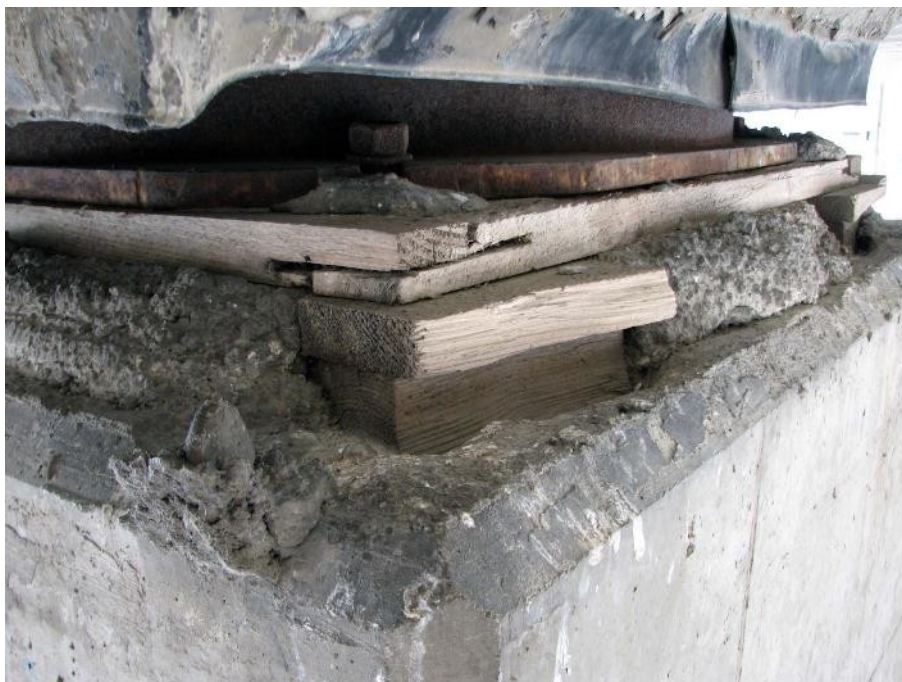
Slika 181: Neustrezno vgrajeno lončno ležišče.
