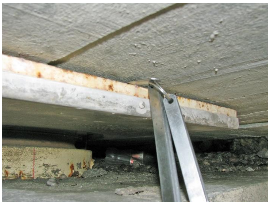
Slika 207: Neustrezen kontakt med drsno ploščo drsnega lončnega ležišča in prečnikom prekladne konstrukcije.
