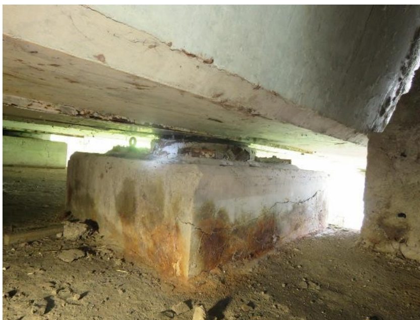
Slika 260: Strižna razpoka v betonskem ležiščnem podstavku. Razpadanje betona zaradi korozije armature. Ležiščna polica v stalni vlagi zaradi netesne dilatacije.
