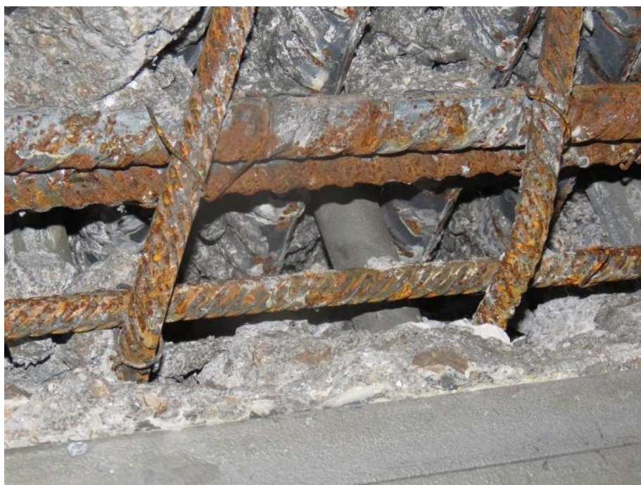
Slika 240: Betonsko gnezdo nad ležiščem zaradi napake pri vgrajevanju in pregoste armature.
