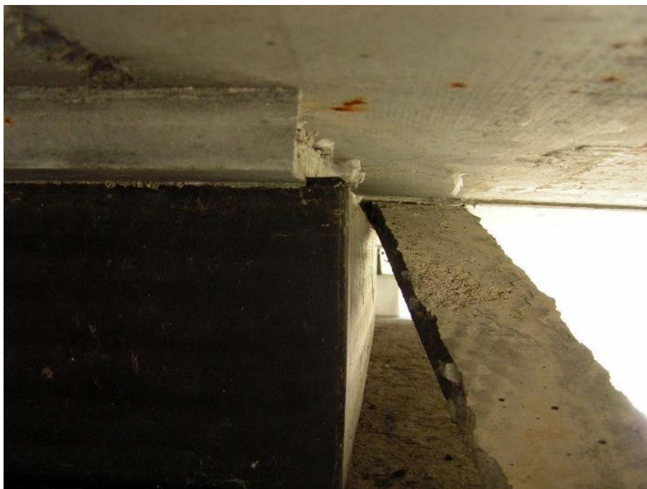
Slika 147: Odlom zgornjega venca zaradi zdrsavanja ležišča. Nepravilna izvedba.
