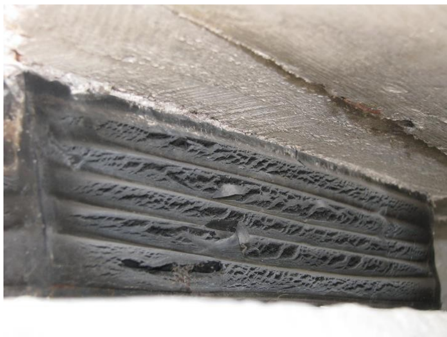
Slika 135: Mrežaste razpoke v elastomerju zaradi izpostavljenosti UV žarkom in ozonu.
