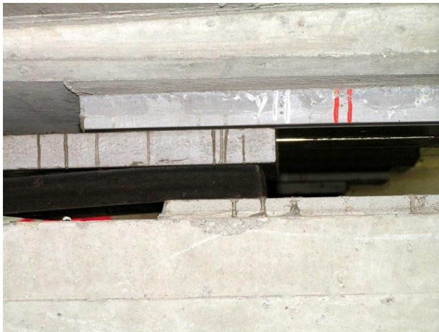
Slika 132: Zdrsavanje (sprehajanje) elastomernega bloka drsnega deformabilnega ležišča po spodnji ležiščni plošči.
