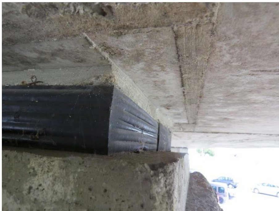
Slika 121: Deformirane jeklene plošče. Popuščanje spoja med vložki in elastomerjem.
