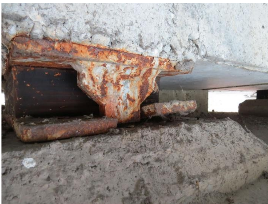
Slika 174: Korozija in deformacija jeklene pridrževalne konstrukcije elastomernega ležišča.
