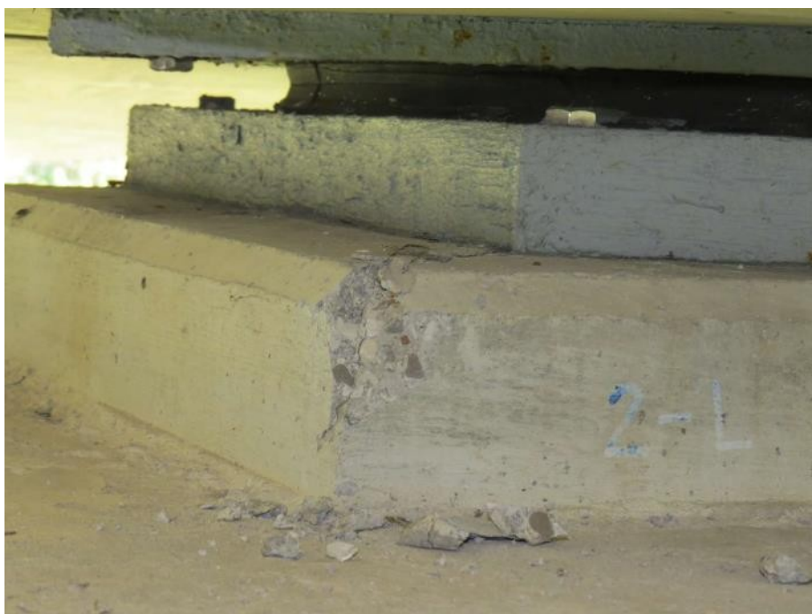
Slika 220: Strižna razpoka v betonskem ležiščnem podstavku.
