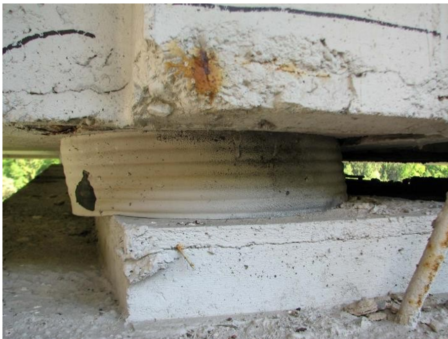
Slika 115: Zdrs elastomernega ležišča preko roba prečnega nosilca vmesne podpore. Ležišče vgrajeno preblizu roba ležiščne blazine.
