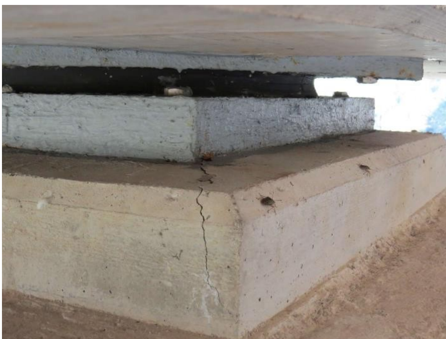
Slika 221: Strižna razpoka v betonskem ležiščnem podstavku.
