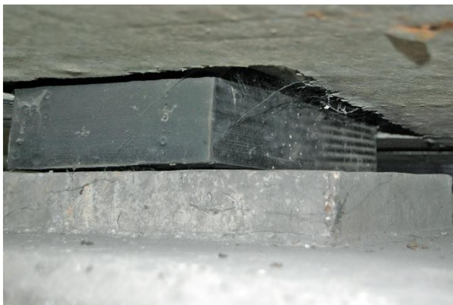
Slika 112: Neenakomerno naleganje elastomernega ležišča na spodnji betonski blazini. Polovica ležišča praktično ni v kontaktu s spodnjo betonsko ležiščno blazino.
