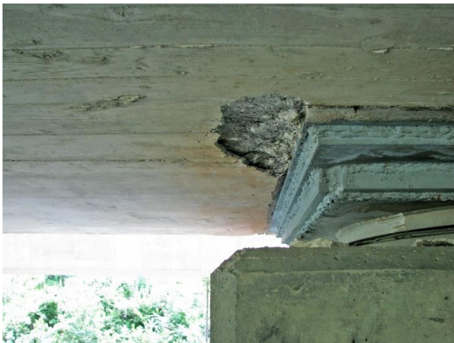
Slika 213: Delaminacija betona okoli sidrne in nad sidrno ploščo zaradi neustreznega varilnega postopka.
