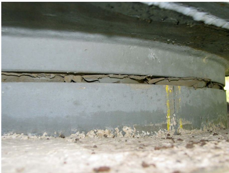
Slika 215: Propadanje tesnilnega traku nagibne reže.
