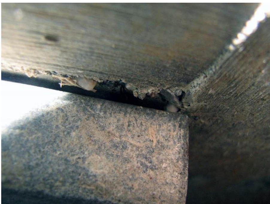
Slika 144: Zdrs zgornje ležiščne plošče deformabilnega ležišča po stiku z ležiščno blazino.
