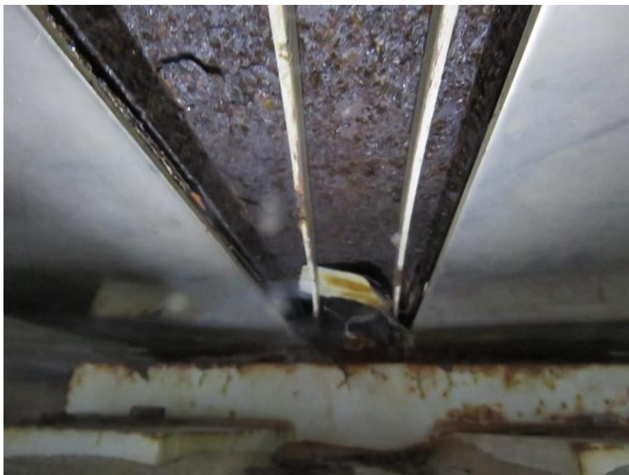
Slika 224: Korozija v utoru drsne plošče lončnega ležišča. Odstopanje drsnih parov (bočni drsni trak in bočna nerjavna pločevina) v utoru drsne plošče.
