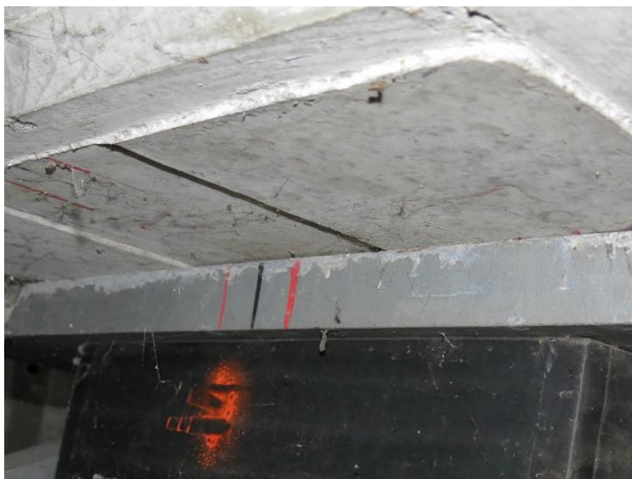
Slika 111: Nepodlita kontaktna površina med zgornjo ležiščno ploščo in betonsko ležiščno blazino.
