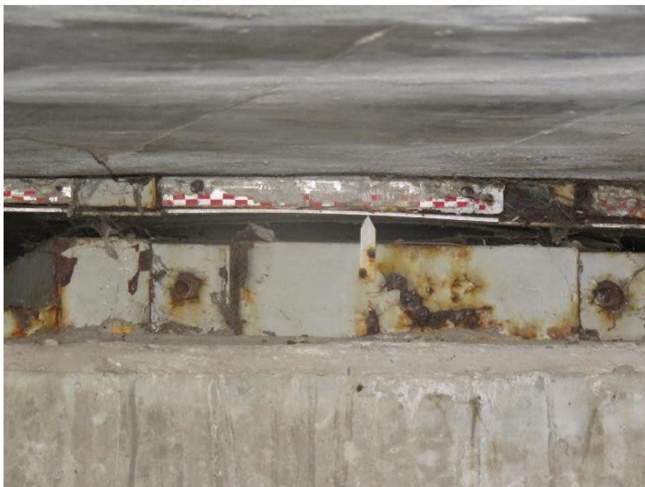
Slika 226: Deformirana drsna pločevina drsne plošče.
