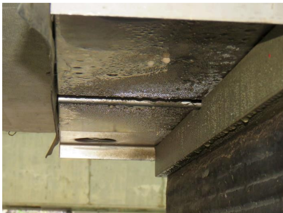
Slika 269: Kondenčna voda na površini ležišča. Ob neustrezni ali poškodovani protikorozijski zaščiti je generator korozijskih procesov.
