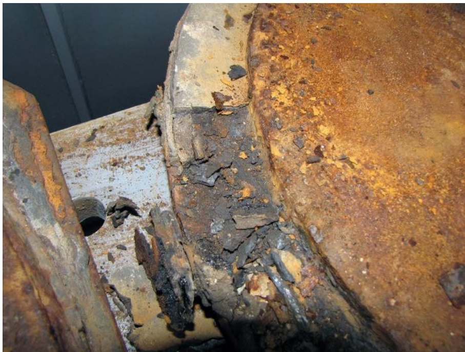
Slika 198: Korozijske poškodbe batnice - detajl.
