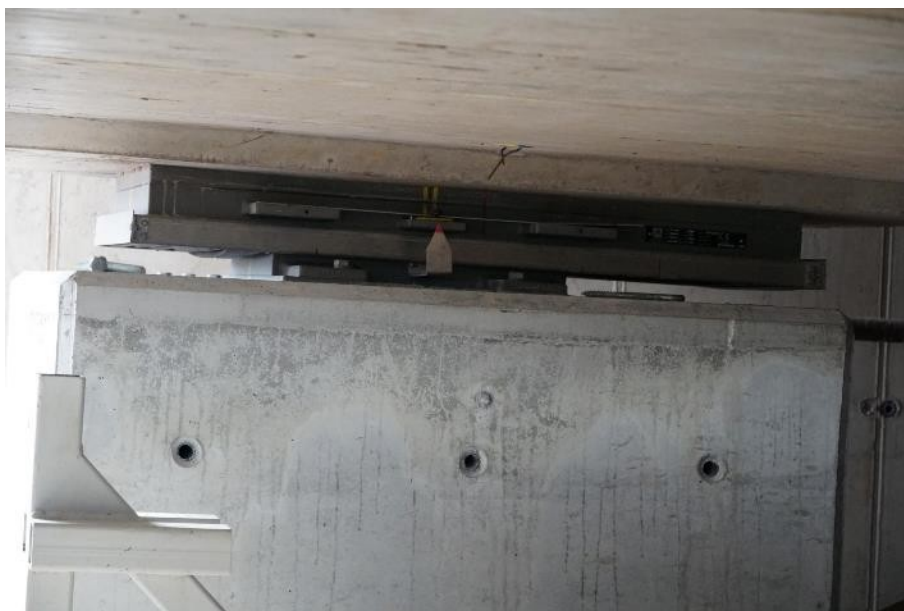
Slika 265: Velikost ležiščnega podstavka neustrezna z ozirom na velikost drsne plošče in premajhnega odmika drsne površine drsne plošče od zgornje površine ležiščnega podstavka.
