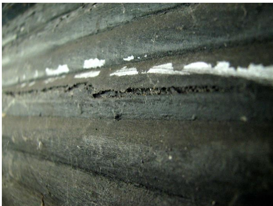
Slika 130: Razpoka zaradi slabe kvalitete krovne plasti elastomerja.
