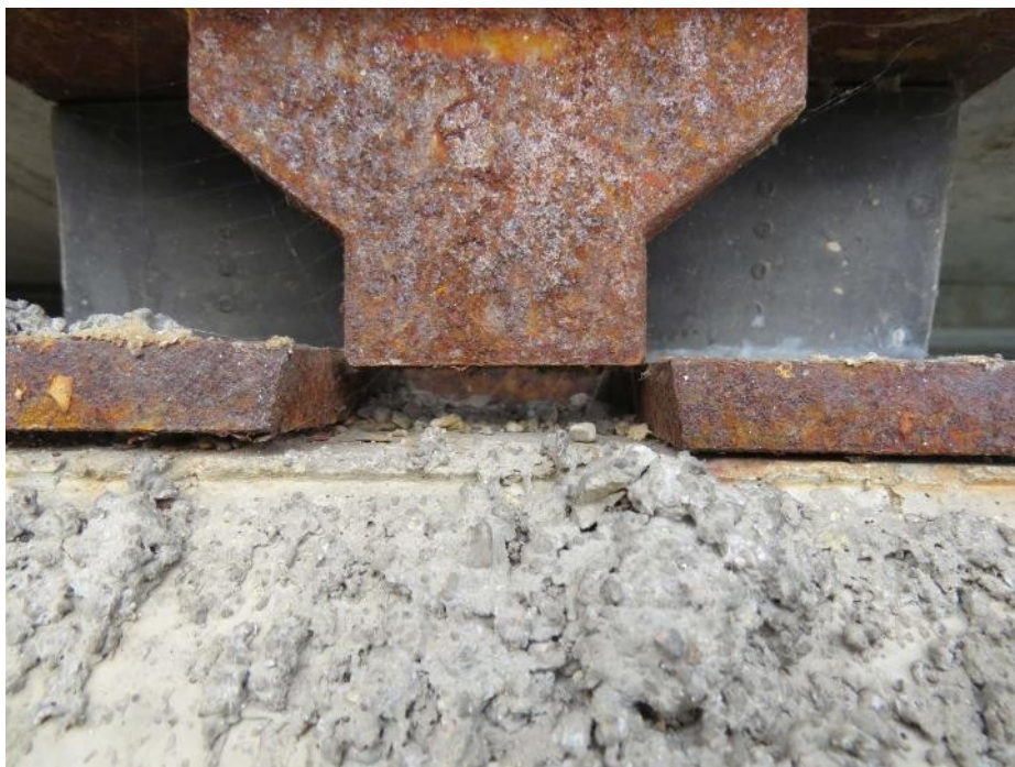
Slika 175: Korozija in deformacija jeklene pridrževalne konstrukcije elastomernega ležišča. Neustrezna izvedba – strižni trn je nad zgornjim robom spodnje ležiščne plošče.
