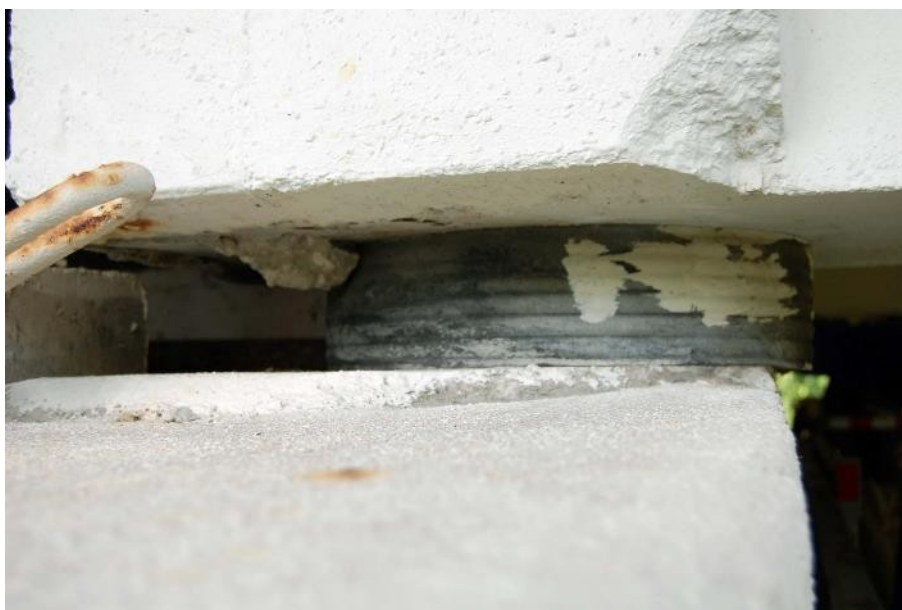
Slika 113: Zdrs elastomernega ležišča preko roba prečnega nosilca vmesne podpore. Ležišče vgrajeno preblizu roba prečnega nosilca.
