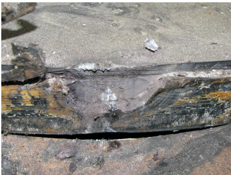
Slika 190: Lokalna poškodba elastomerne blazine na mestu iztiskanja.
