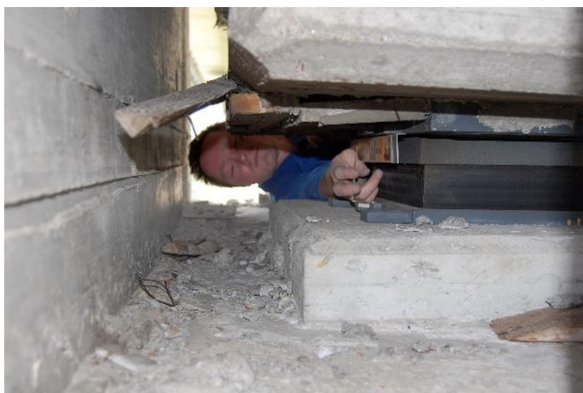
Slika 263: Kazalec pomikov in merilna skala vgrajena na napačni strani ležišča. Zaradi premajhnega razmika me ležiščem in parapetnim zidom je težko dovolj natančno oziroma je nemogoče odčitati velikost pomika.
