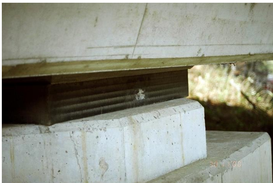
Slika 163: Nepravilna zamenjava oblike deformabilnega ležišča po že izvedenem ležiščnem podstavku.
