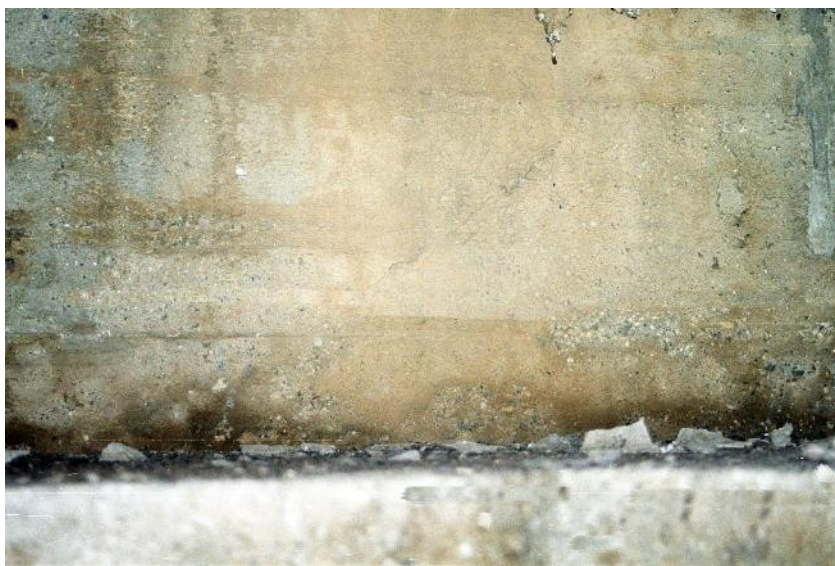
Slika 254: Betonsko valjčno ležišče – strižna razpoka.
