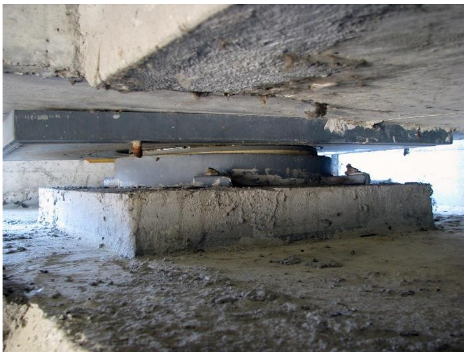
Slika 231: Prevelik zasuk lončnega ležišča. Drsna plošča ni v popolnem kontaktu s prekladno konstrukcijo – spodnjo površino montažnega prednapetega betonskega nosilca.
