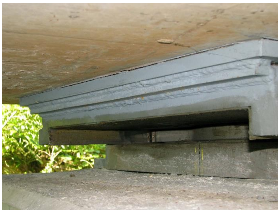
Slika 209: Nepodliti stik med loncem in betonskim podstavkom.
