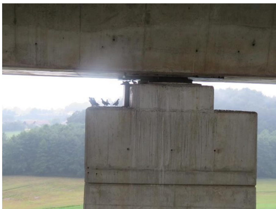
Slika 267: Ležišče nezaščiteno pred dostopom ptic. Ležiščna polica nezavarovana pred padcem v globino. Zaradi dimenzij betonskega podstavka je meritve ležišča možno izvajati le na notranji strani ležišča.
