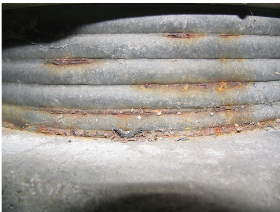
Slika 129: Korozija jeklenih vložkov elastomernega ležišča zaradi stalne prisotnosti vlage in solnice.
