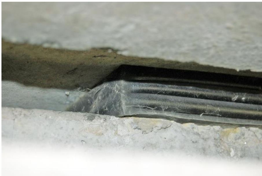
Slika 119: Nepravilna vgradnja elastomernega ležišča na rob ležiščne blazine. Prisotno zdrsavanje ležišča. Zaradi neenakomernega naleganja in velikih lokalnih robnih napetosti prisotne izrazite gube na čelni površini.
