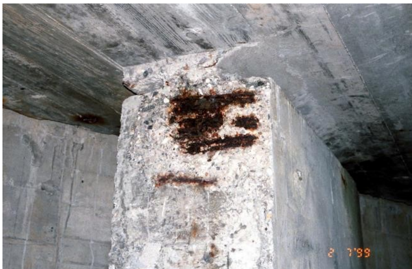
Slika 259: Lokalna delaminacija betona zaradi močne korozije armature nihajnega bloka betonskega členka.
