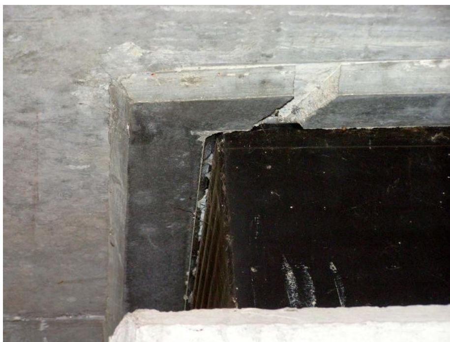
Slika 148: Odlom zgornjega venca zaradi zdrsavanja ležišča. Nepravilna izvedba kontaktne površine podlivne malte in prekladne konstrukcije in neustrezna prijemnost obeh površin.
