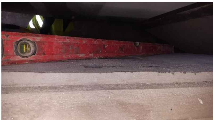
Slika 168: Neustrezno izvedeno podlivanje ležiščne plošče deformabilnega ležišča.
