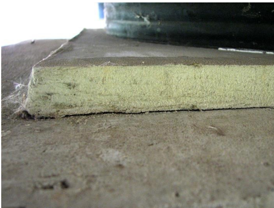
Slika 178: Odprti stik vogala spodnje ležiščne plošče s spodnjim betonskim ležiščnim podstavkom.
