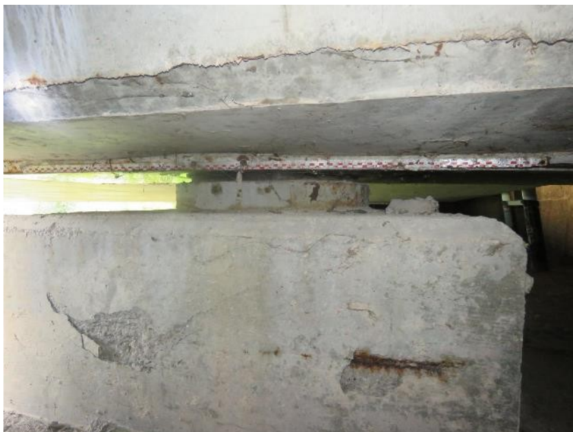
Slika 262: Delaminacija betona ležiščnega podstavka zaradi korozije armature.
