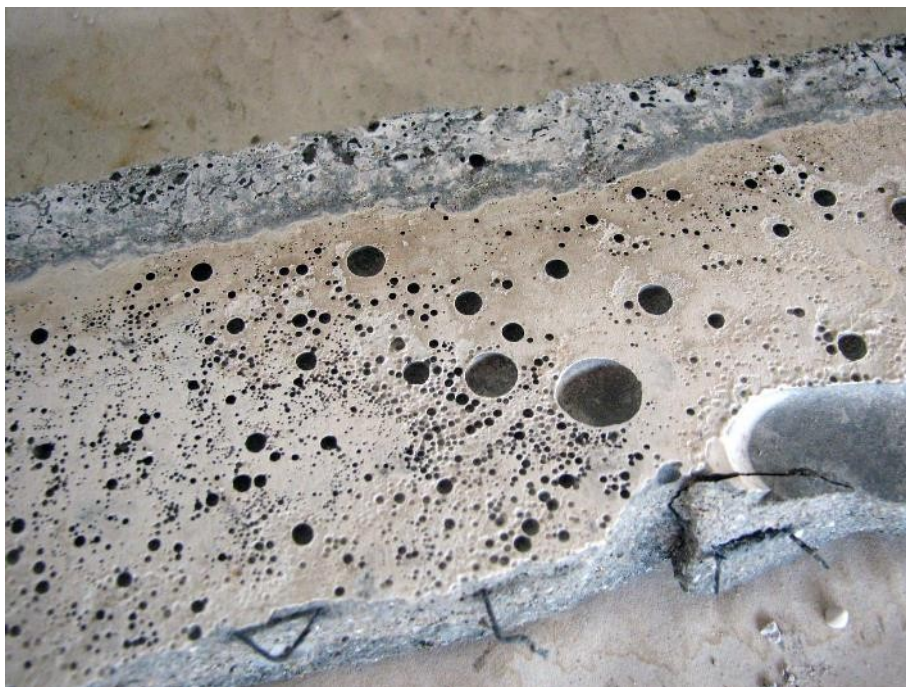
Slika 149: Zračni mehurji v kontaktni površini podlivne malte s prekladno konstrukcijo.
