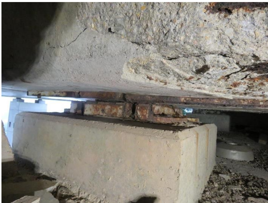
Slika 228: Korozija ležišča zaradi zamakanja skozi dilatacijo. Propadanje betona ob ležišču.
