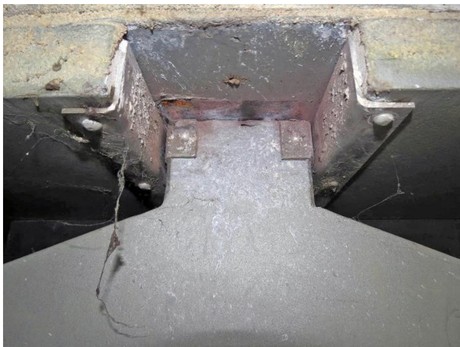
Slika 110: Nepravilna izvedba in vgradnja deformabilnega ležišča s pridrževalno konstrukcijo za preprečevanje pomikov v prečni smeri. Zgornja površina trna v kontaktu z ležiščno ploščo. Drsna površina utora ležiščne plošče umazana.
