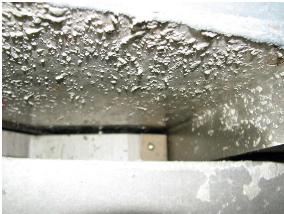
Slika 211: Umazana drsna površina z betonskim obrizgom.
