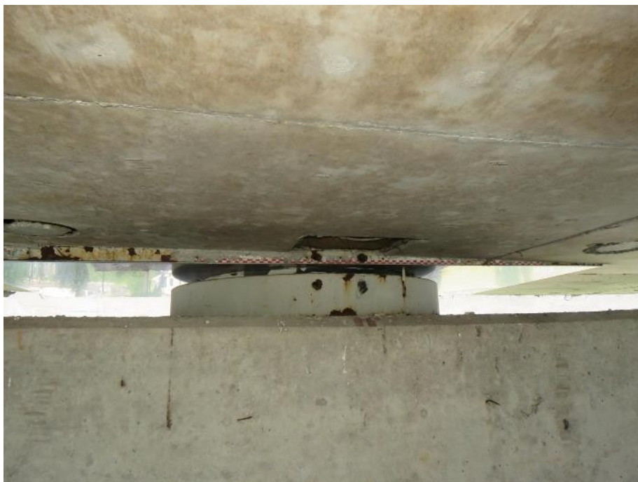
Slika 227: Nepravilno vgrajeno drsno ležišče, drsna plošča vgrajena v prekladno konstrukcijo.
