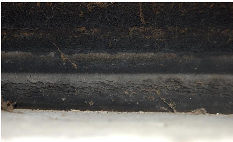
Slika 134: Razpoke v elastomerju zaradi procesa staranja in/ali slabe kakovosti krovne plasti elastomerja.
