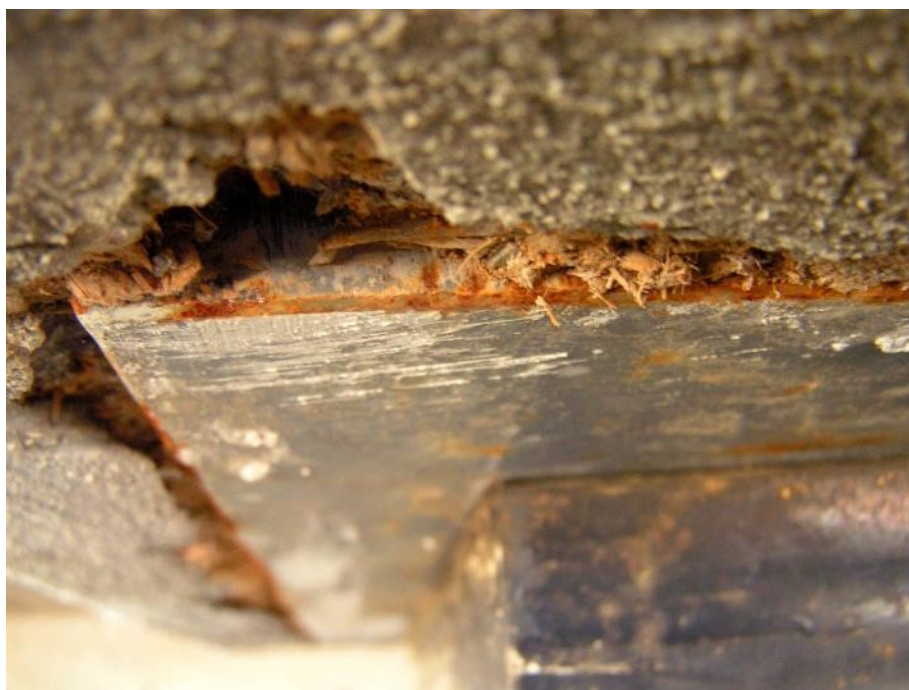
Slika 151: Napaka pri vgradnji zgornje ležiščne plošče. Neočiščena površina okoli stika zgornje ležiščne plošče z opažem ležiščne blazine pred pričetkom betoniranja.
