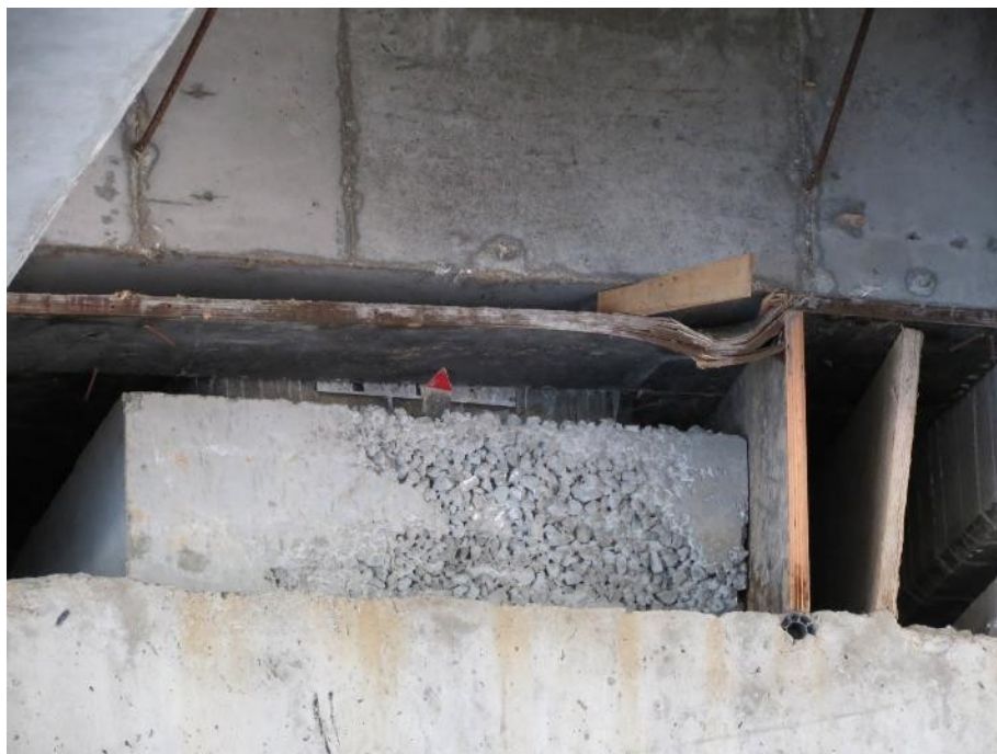
Slika 222: Porozen beton ležiščnega podstavka. Dršno ležišče vgrajeno prečno namesto v vzdolžni smeri.
