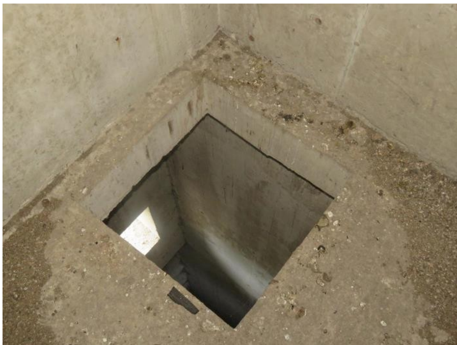
Slika 268: Nezaščiten dostopna odprtina na podest stebra. Površina podesta pokrita s ptičjimi iztrebki.
