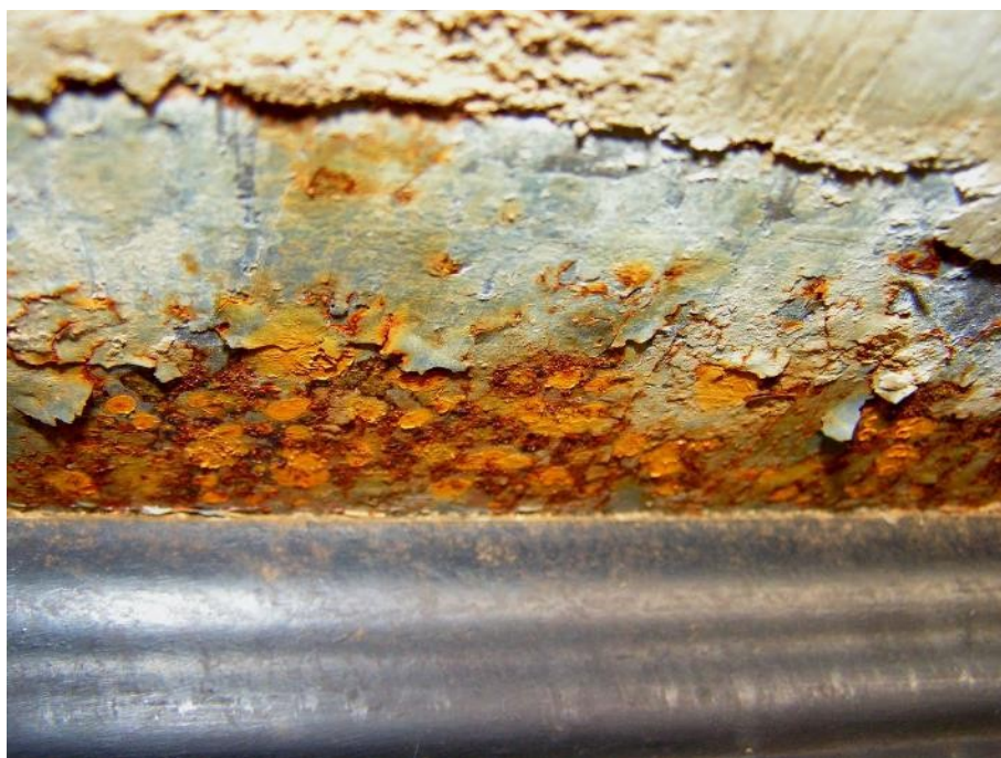
Slika 150: Korozija zgornje ležiščne plošče zaradi neustrezno izvedene protikorozijske zaščite.
