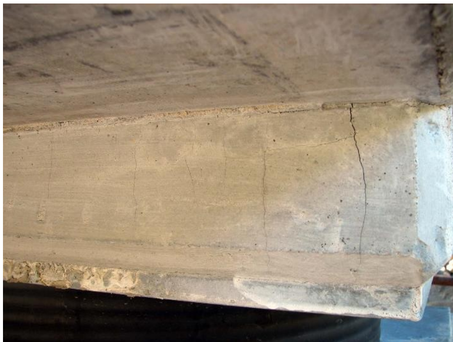
Slika 164: Razpoke v podlivni malti med zgornjo ležiščno ploščo in prekladno konstrukcijo.
