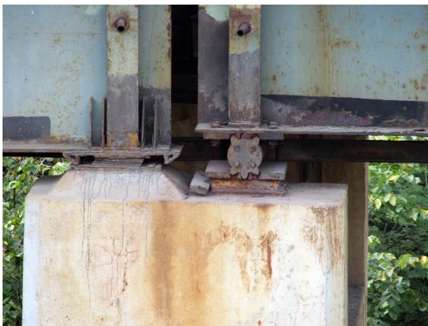
Slika 246: Enojno valjčno ležišče – korozija.
