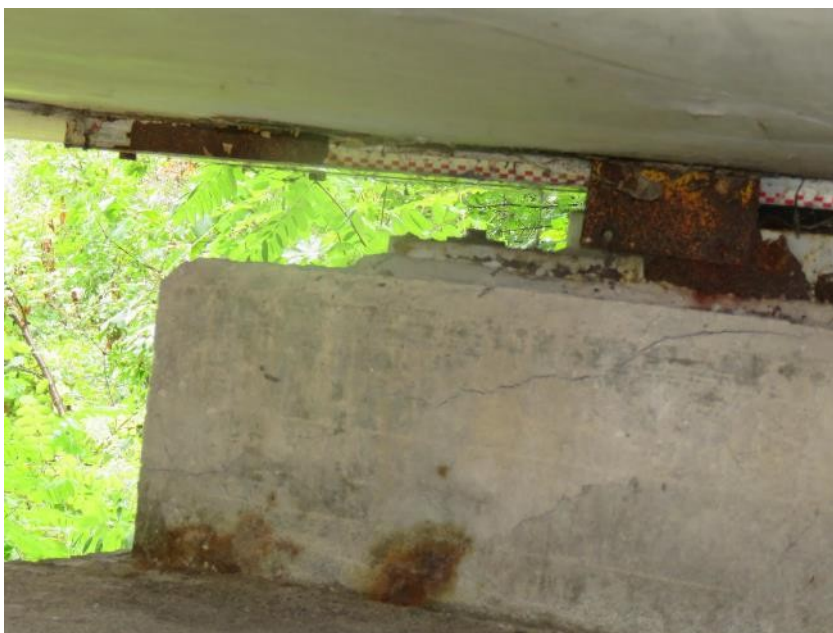
Slika 261: Strižna razpoka v betonskem ležiščnem podstavku.
