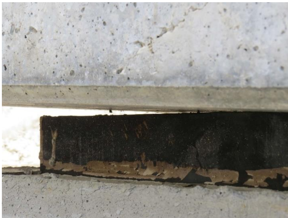
Slika 162: Neustrezna in nepravilna vgradnja elastomernega ležišča pod betonskim montažnim nosilcem. Ležišče zalito v podlivno malto. Povezava ležišča z montažnim nosilcem ni bila rešena.
