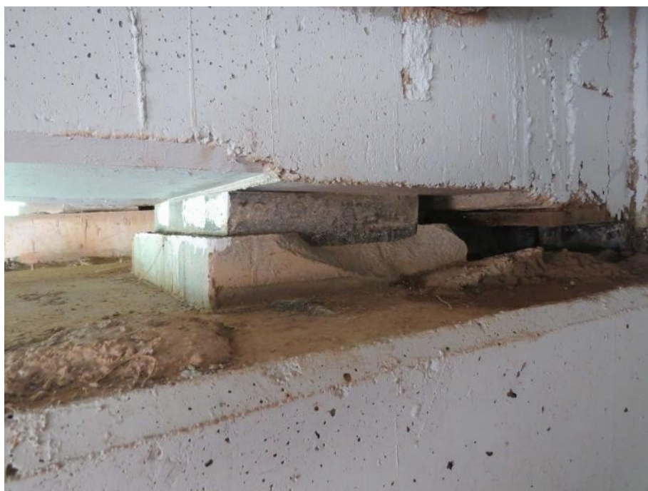
Slika 160: Neustrezna in nepravilna vgradnja elastomernega ležišča pod betonskim montažnim nosilcem.
