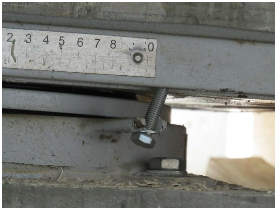
Slika 230: Vijak ključavnice za fiksiranje ležišča za fazo transporta in vgradnje po vgradnji ležišča ni bil sproščen.
