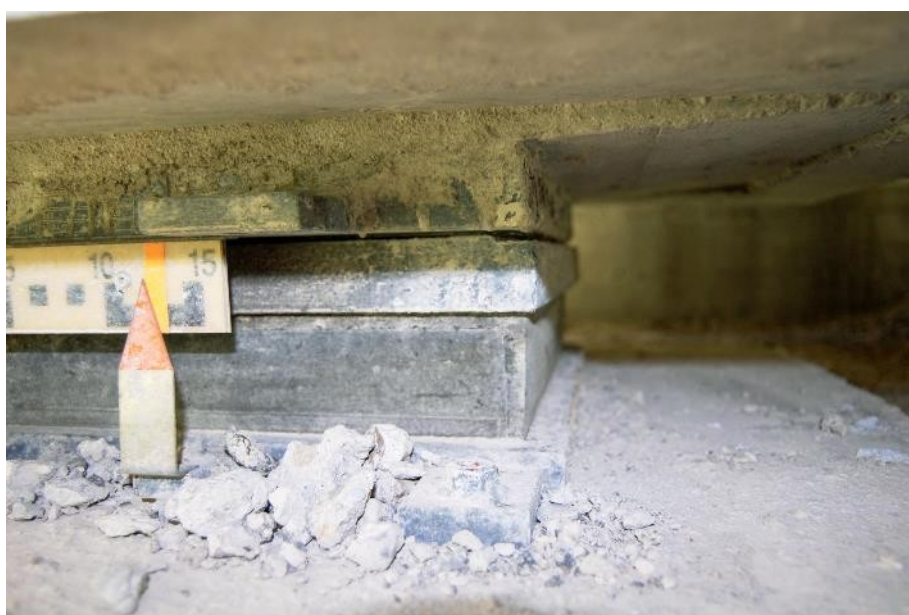
Slika 159: Prevelik pomik drsnega dela deformabilnega ležišča zaradi vgradnje ležišča v napačni smeri.
