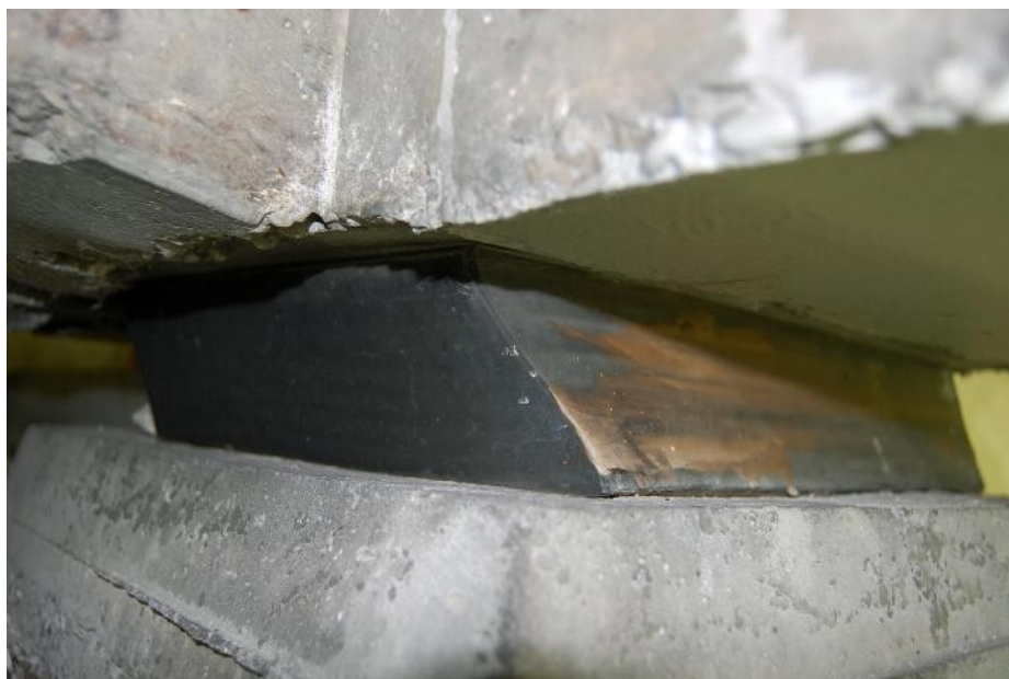
Slika 118: Neenakomerno naleganje na ležišče. Prevelika deformacija ležišča, ki je deformirano tudi okoli vertikalne osi (torzijski zasuk ležišča v horizontalni ravnini).
