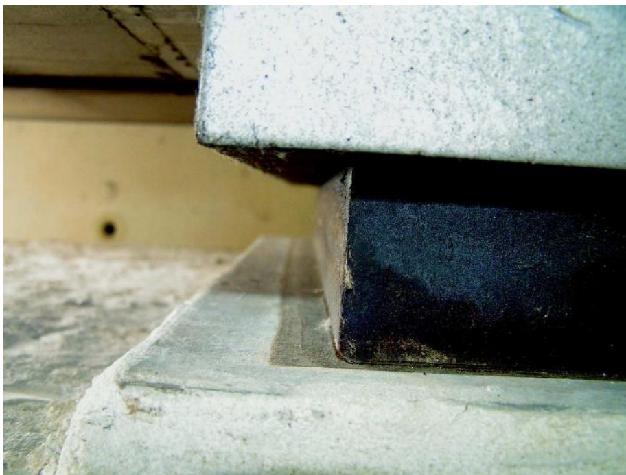
Slika 131: Zdrsavanje (sprehajanje – ang. walking out) elastomernega bloka drsnega deformabilnega ležišča po spodnji ležiščni plošči.
