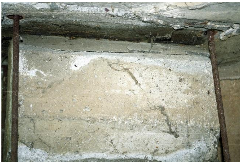
Slika 253: Betonsko valjčno ležišče – delaminacija betona na vrhu ležišča.
