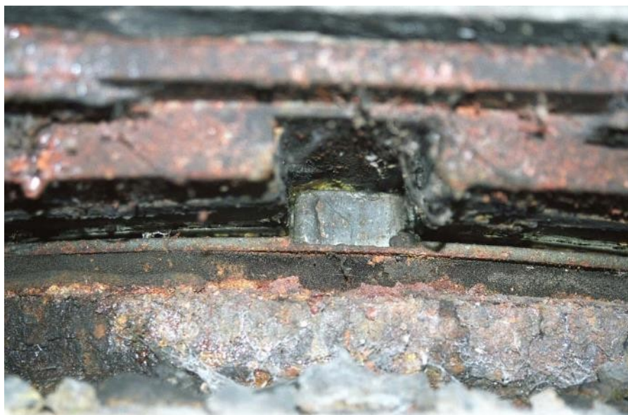
Slika 210: Korozija lončnega ležišča zaradi stalne prisotnosti vlage in umazanije na ležiščni polici.
