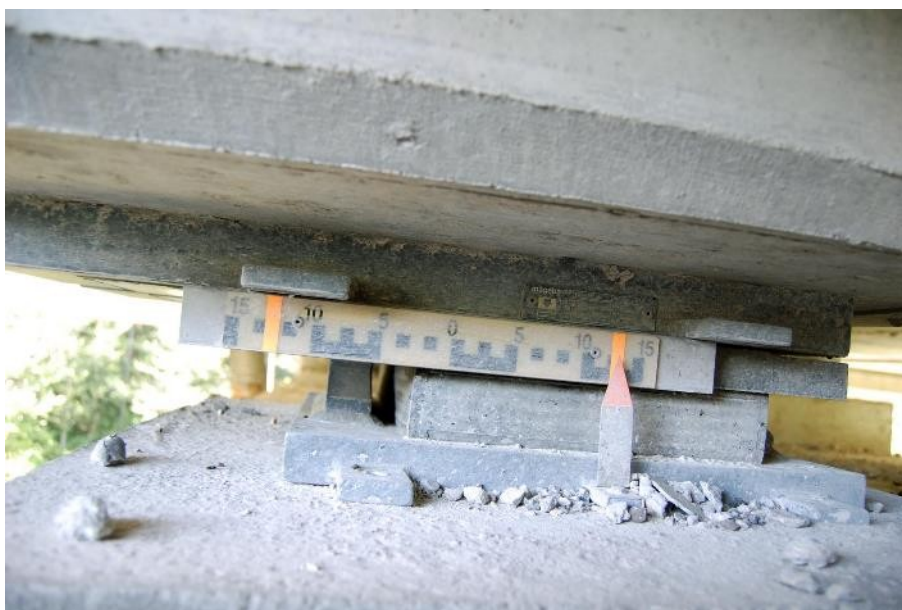
Slika 158: Prevelik pomik drsnega dela deformabilnega ležišča zaradi vgradnje ležišča v napačni smeri.
