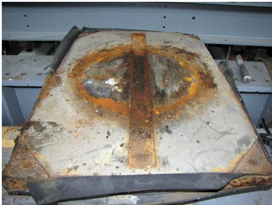
Slika 200: Korozijske poškodbe drsne plošče.
