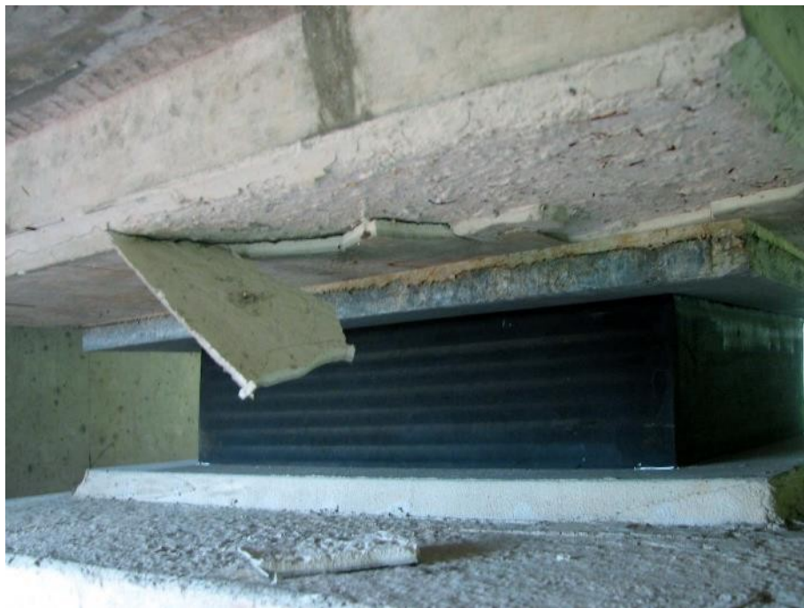
Slika 153: Nekvalitetno izveden zgornji ležiščni blok.
