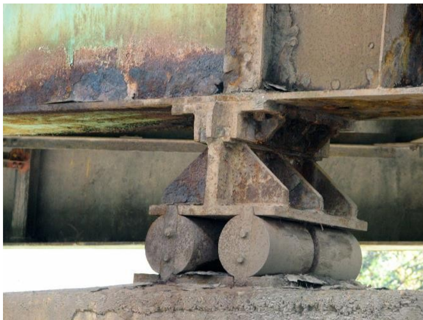
Slika 247: Dvojno valjčno ležišče – korozija zaradi zamakanja.
