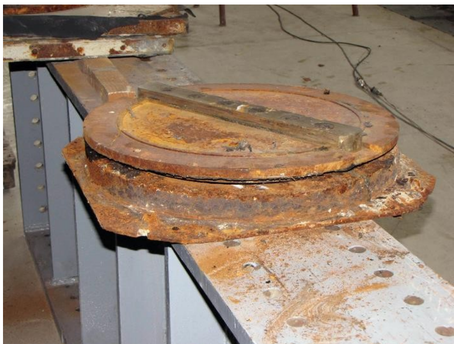
Slika 199: Korozija lončnega ležišča.
