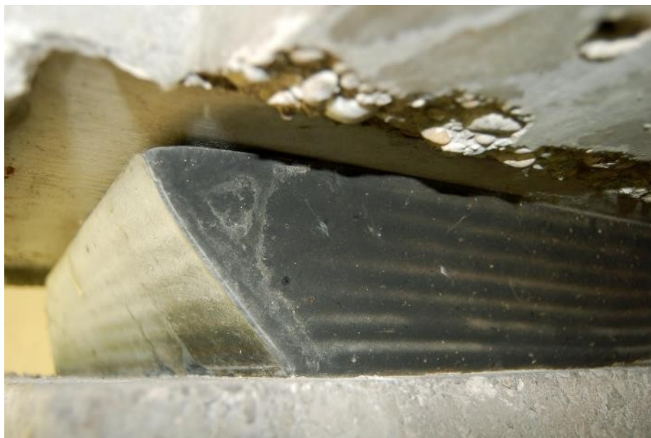
Slika 117: Neenakomerno naleganje na ležišče. Prevelika deformacija ležišča, ki je deformirano tudi okoli vertikalne osi (torzijski zasuk ležišča v horizontalni ravnini).
