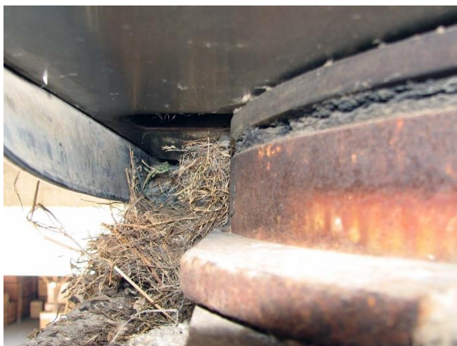
Slika 180: Neustrezno zaščitena drsna površina lončnega ležišča. Korozija lončnega ležišča. Razpokano in dotrajano tesnilo nagibne špranje.
