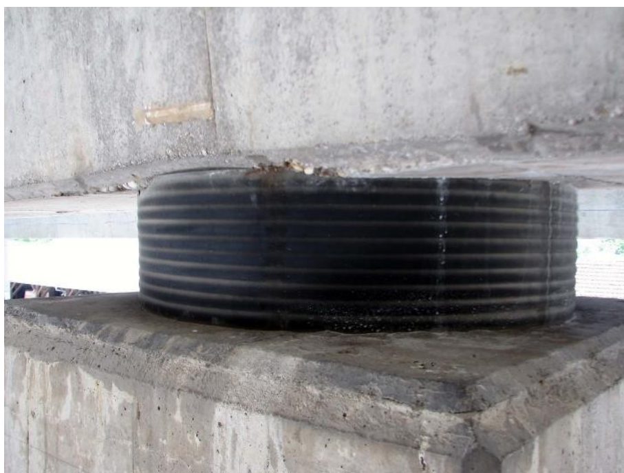
Slika 167: Neustrezno izbrano ležišče glede na dimenzije nosilca prekladne konstrukcije.
