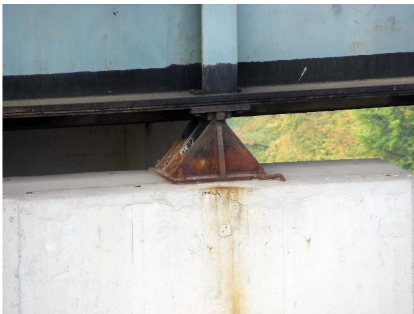
Slika 244: Linijsko nagibno ležišče – korozija.
