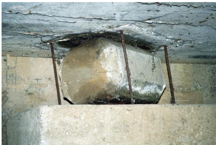
Slika 255: Betonsko valjčno ležišče – cepilne razpoke na bočni površini ležišča.
