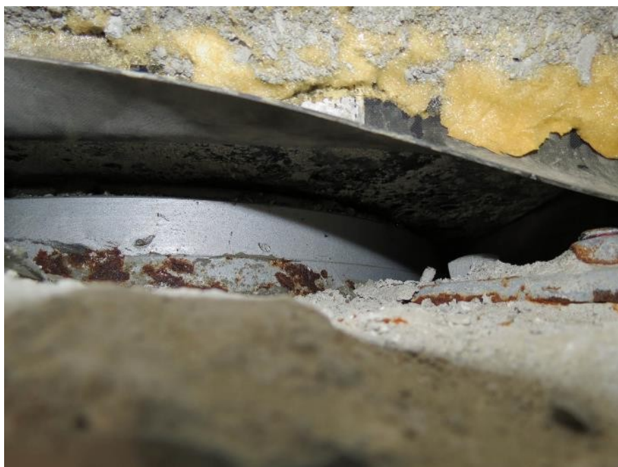
Slika 223: Lokalna korozija na mestu poškodb protikorozijske zaščite, ki so nastale ob vgrajevanju ležišča.
