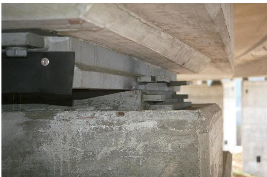
Slika 203: Bočno vodilo lončnega ležišča nasedlo na lonec zaradi neustreznega podlitja ležišča.
