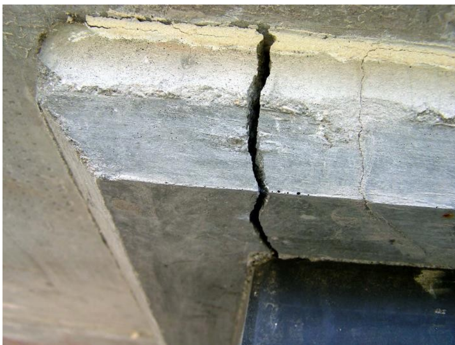
Slika 145: Razpoka v zgornjem vencu zaradi deformacije – zdrsavanja – ležišča.
