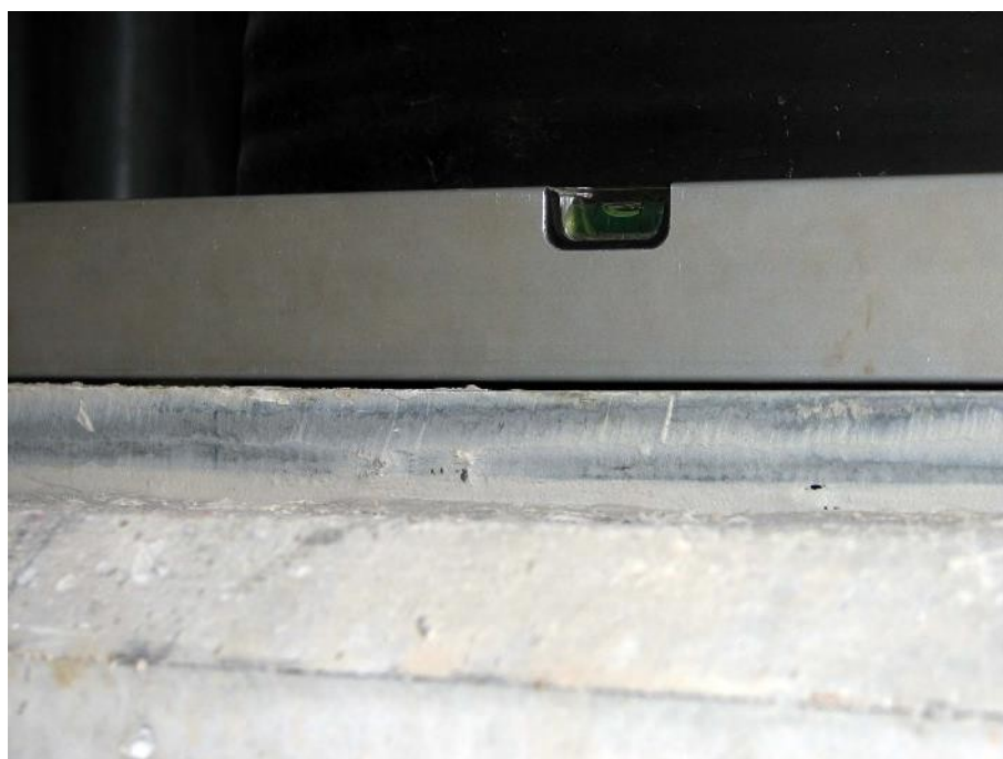
Slika 165: Deformirana spodnja ležiščna plošča elastomernega ležišča.
