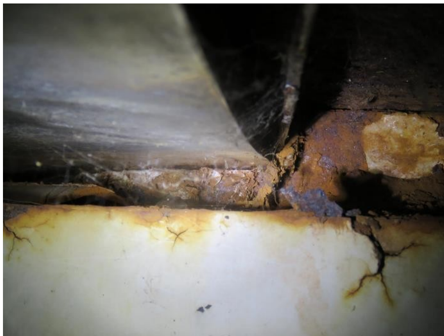
Slika 225: Naleganje drsne plošče na rob batnice lončnega ležišča. Zaradi obrabe teflona drsna plošče v kontaktu z robom utora batnice. Deformirana drsna pločevina. Ostružki teflona.
