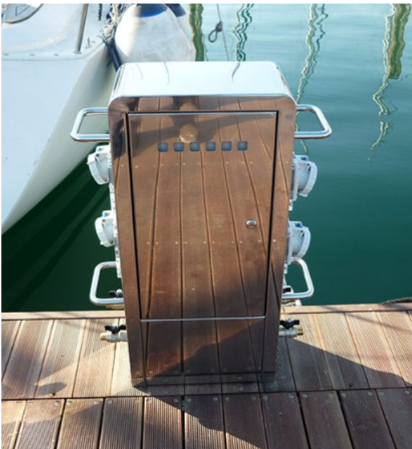
Figuur 4: Water- en energievoorzieningsdoos pieren
