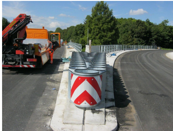
Фигура 1 — Система за поглъщане на енергия при сблъсък (CEAS), монтирана на мост в зоната на разделителните островчета
